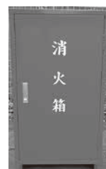
初期消火箱例
