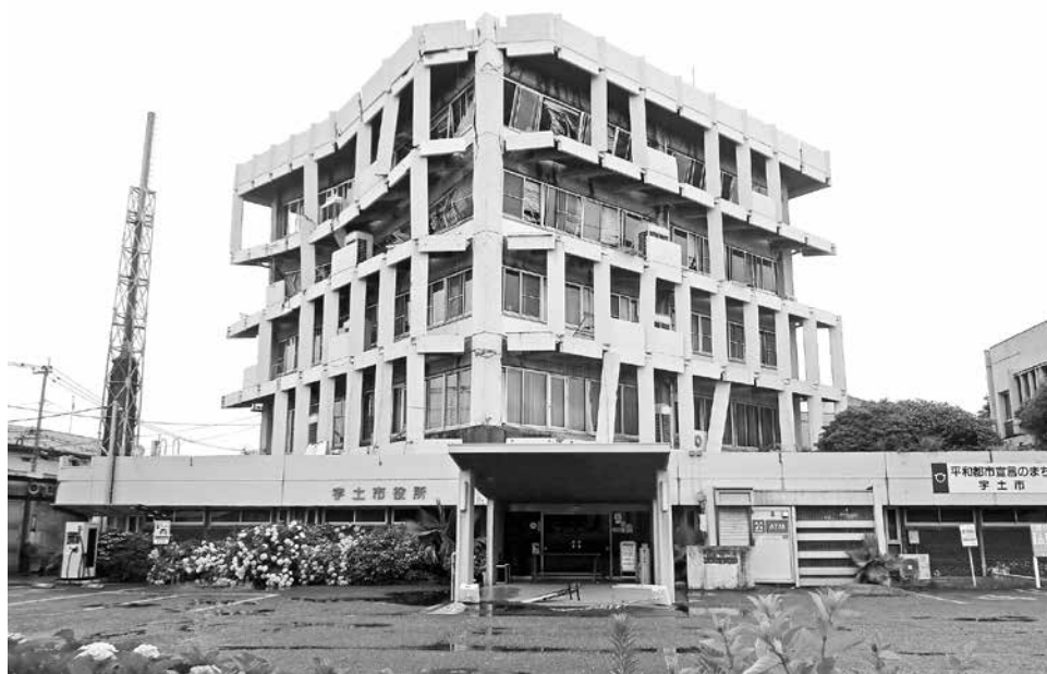
全壊した宇土市役所庁舎
