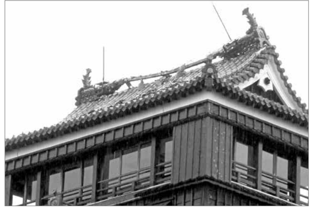
崩壊した熊本城天守閣最上部
